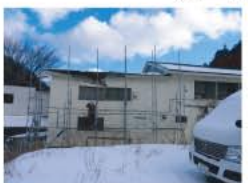
▲屋根が雪害で破損しました
